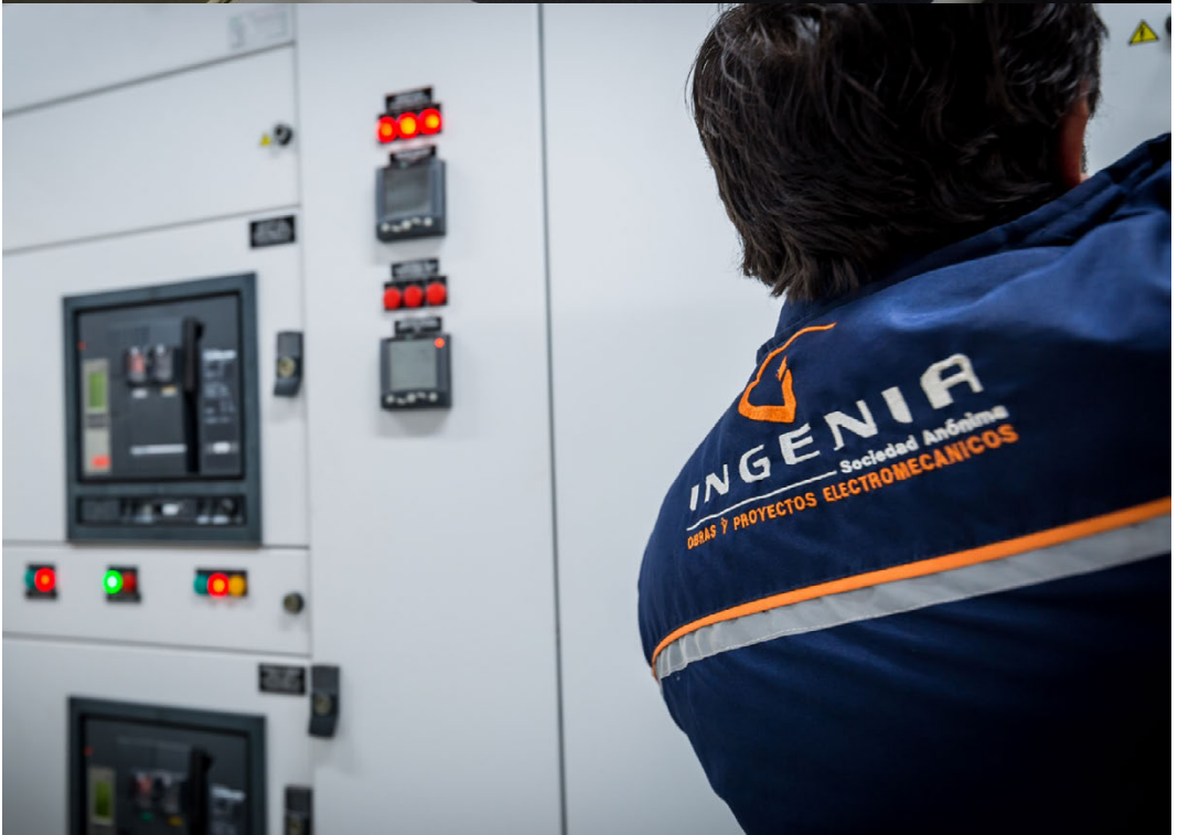
Supervisión de tablero eléctrico para mantenimiento eléctrico industrial.
