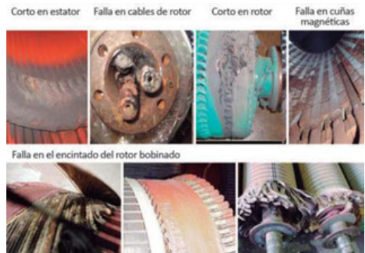
Figura 4. Fallas eléctricas en aerogeneradores.
